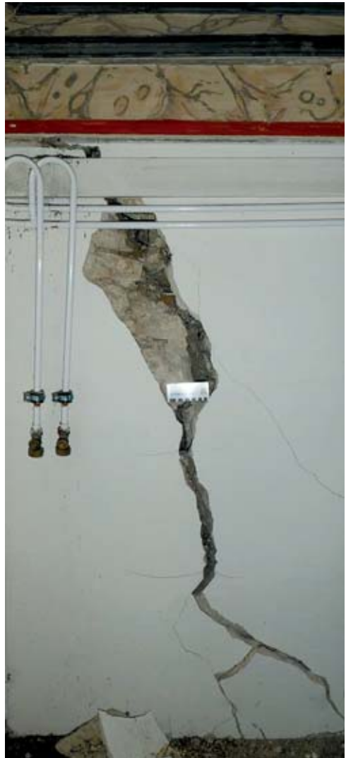
Südwestecke Schiff, obere Empore und Deckenanschluss, massive Risse in der Westwand des Schiffes
